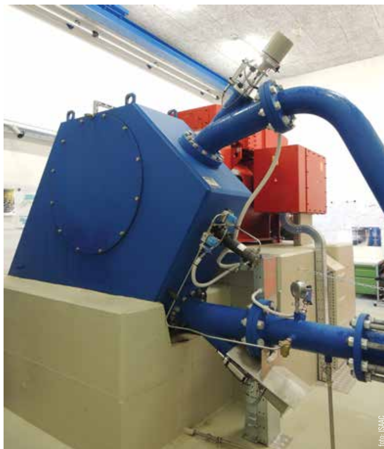
Impianto idroelettrico sull'acquedotto di Sigirino (AIL SA).
