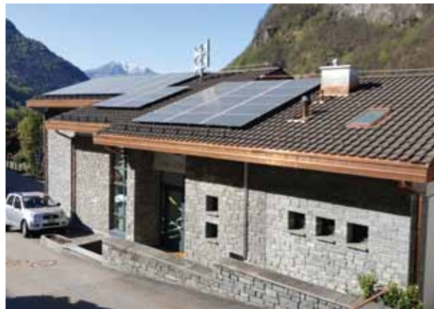
Casa comunale di Vogorno: 29,9 kWp, gruppo B nella figura [F. 1]
